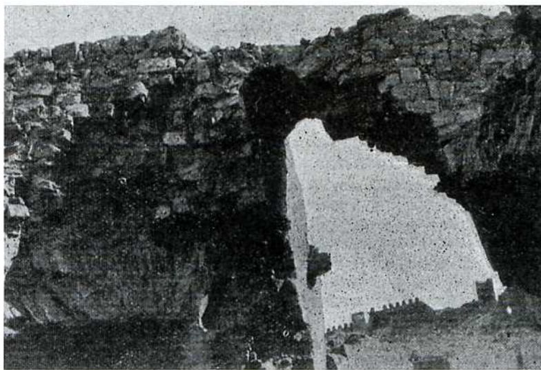
Fig. 12.ª—Aspecto del arco (n.º 6), antes de su consolidación. Compruébese su aspecto actual en la Fig. 9.ª.
