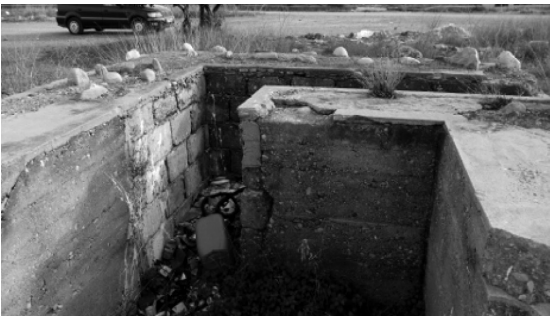
Entrada indirecta amb passadís en forma de L s'observa el revestiment de blocs de pedra i les marques d'encofrat.
